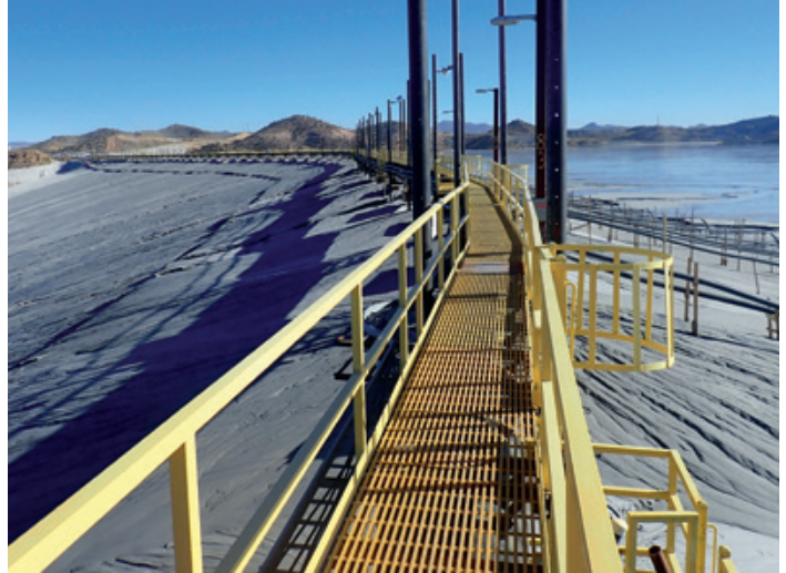
Plataforma de la tubería de distribución de relaves y sistema hidráulico de soporte de la disposición de relaves en la línea central del depósito de relaves Upper Mammoth de Bagdad (Estados Unidos). La plataforma soporta 85 separadores ciclónicos en la prensa utilizados para separar el material en fracciones gruesas y finas, donde la fracción gruesa se usa para construir un terraplén de drenaje libre para el depósito de almacenamiento de relaves.
