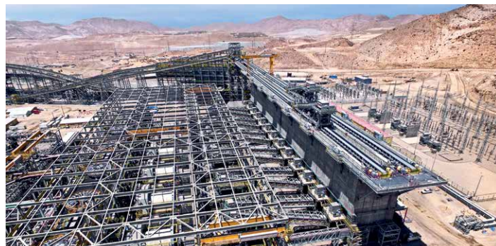
La expansión de la concentradora de Cerro Verde incluye un circuito de Rodillo de Molienda de Alta Presión que es aproximadamente 40 por ciento más eficiente en términos de energía que un circuito de Molino Semi-Autógeno tradicional. El proyecto triplicó las instalaciones de la concentradora de 120.000 toneladas métricas de mineral por día a 360.000.
