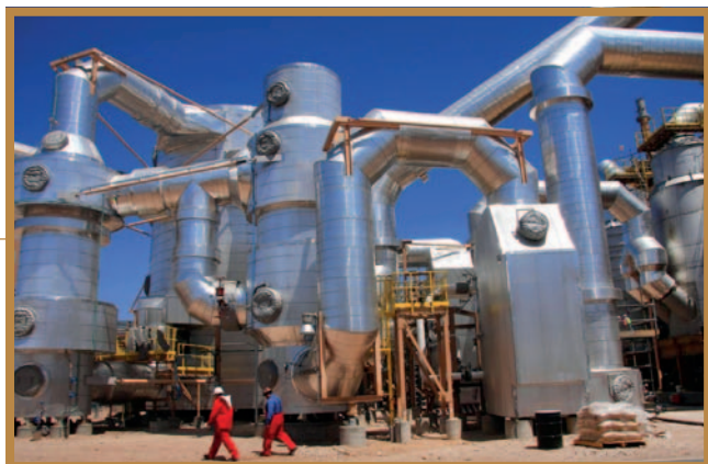
Photo : En 2011, nous avons achevé la construction d'un brûleur de soufre à Safford. L'usine fournit une source plus rentable d'acide sulfurique utilisé dans les opérations de lixiviation de cuivre et permet une diminution des coûts de transport. Non seulement l'usine produit de l'acide sulfurique, mais la chaleur créée dans le processus est utilisée pour produire de la vapeur à haute pression qui alimente une turbine pour produire 15 mégawatts d'électricité. L'électricité est utilisée par l'usine et les installations de traitement, y compris la cuve, et permettra à la Société d'économiser environ 5,7 millions de dollars par an en coûts d'énergie.
