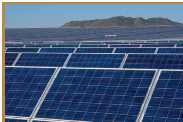
Photo : Une installation solaire de 15,5 mégawatts a été mise en place sur le terrain de la Société à Bagdad, en Arizona. Notre opération de Bagdad achète l'énergie produite dans l'installation, ce qui représente 5 % des besoins en électricité de l'opération et devrait faire économiser à la Société plus de 700 000 $ annuels. L'installation devrait fonctionner pendant 25 ans.
