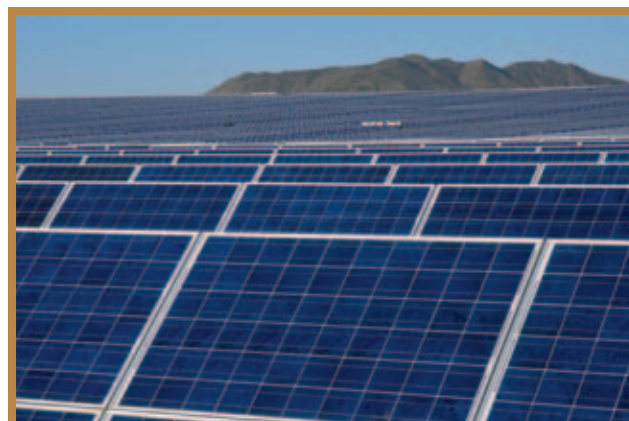
Foto: Se encargó la construcción de una instalación solar de 15,5 megavatios en tierras de la Compañía en Bagdad, Arizona. Nuestra operación de Bagdad compra energía eléctrica generada en la instalación, la cual representa el 5 por ciento de las necesidades de electricidad de la operación y se proyecta que la compañía ahorrará más de US$ 700.000 al año. Se proyecta que las instalaciones operen durante un período de hasta 25 años.
