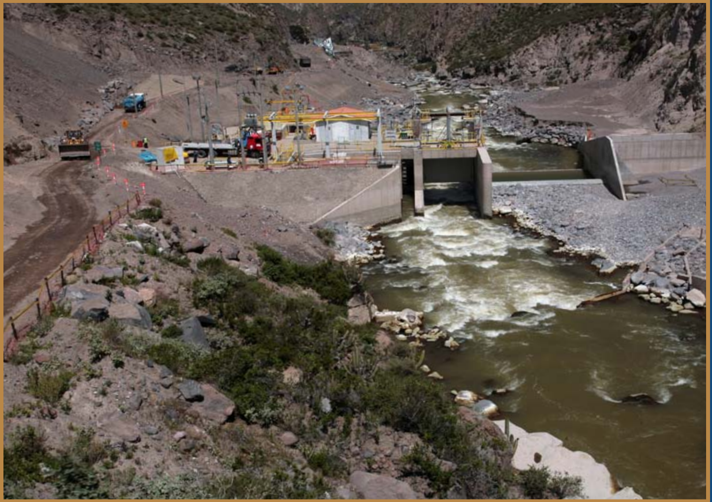
Estructura de la entrada de la nueva planta de tratamiento de agua potable.
